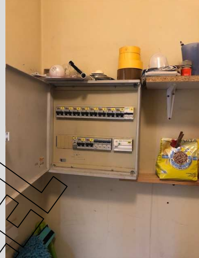
(Elektrisch verdeelbord - Foto buiten)
