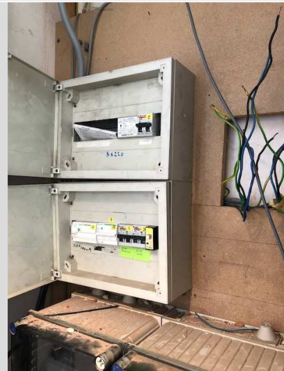
(Elektrisch bord - foto buitenkant)
